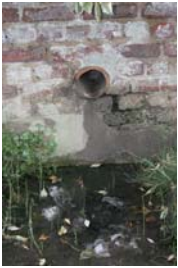
Rejet « individuel » d'eau usée
