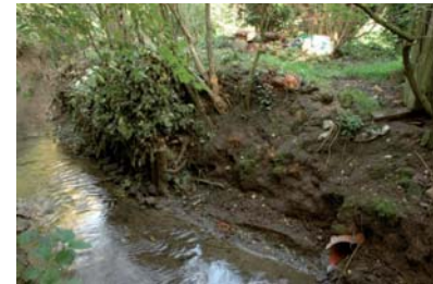
Dégradation et affaiblissement de berge
